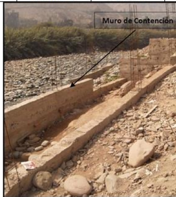
Figura 33: Presencia de barreras de contención construidas en terrenos no compactos por lo tanto se observa erosión en su base. En la figura de abajo se observa que el agua del río Rímac se encuentra a nivel de la base de la vivienda que está en etapa de construcción.
