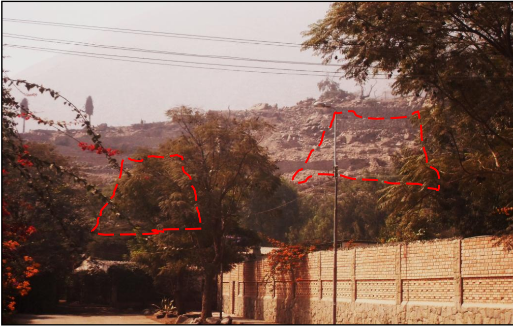
Figura 20: Caída de rocas en las inmediaciones del cerro de la Urb. 3 de Octubre. Margen izquierda del río Rímac.
